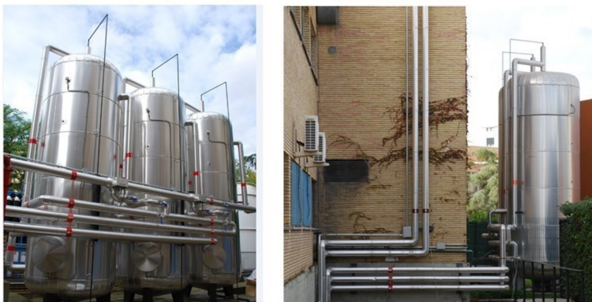
Figura 98: Montaje de acumuladores solares en el exterior y los circuitos hidráulicos que los conectan
