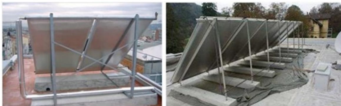
Figura 54: Ejemplos de bloques de hormigón como base de reparto y contrapeso de la estructura soporte de captadores
