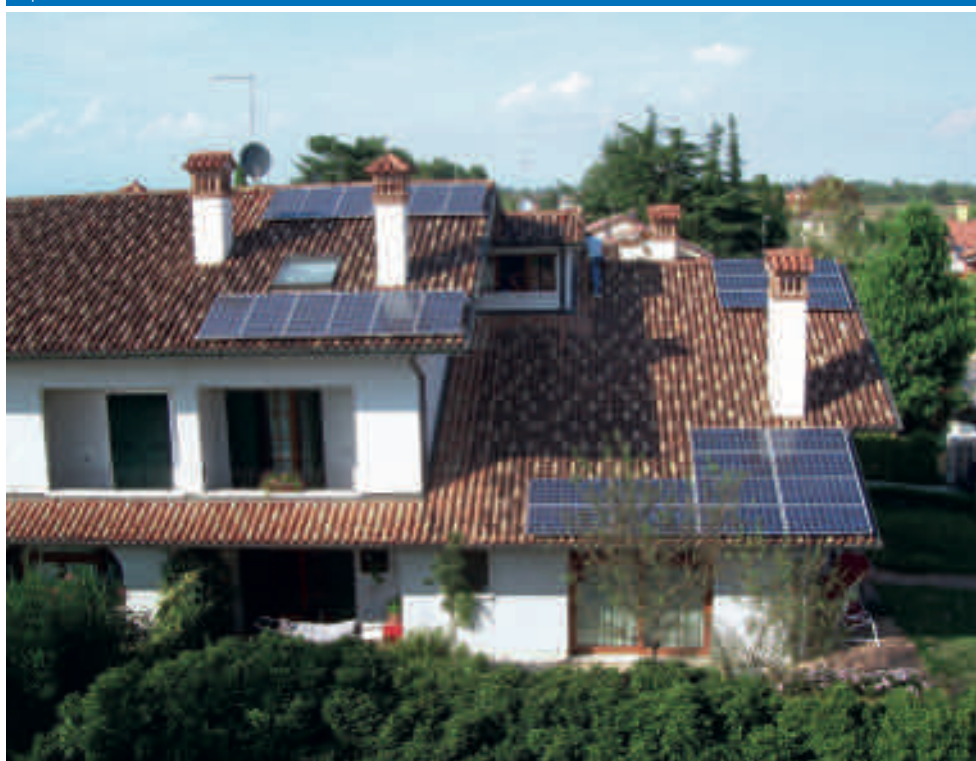
Impianti fotovoltaici su tetto
