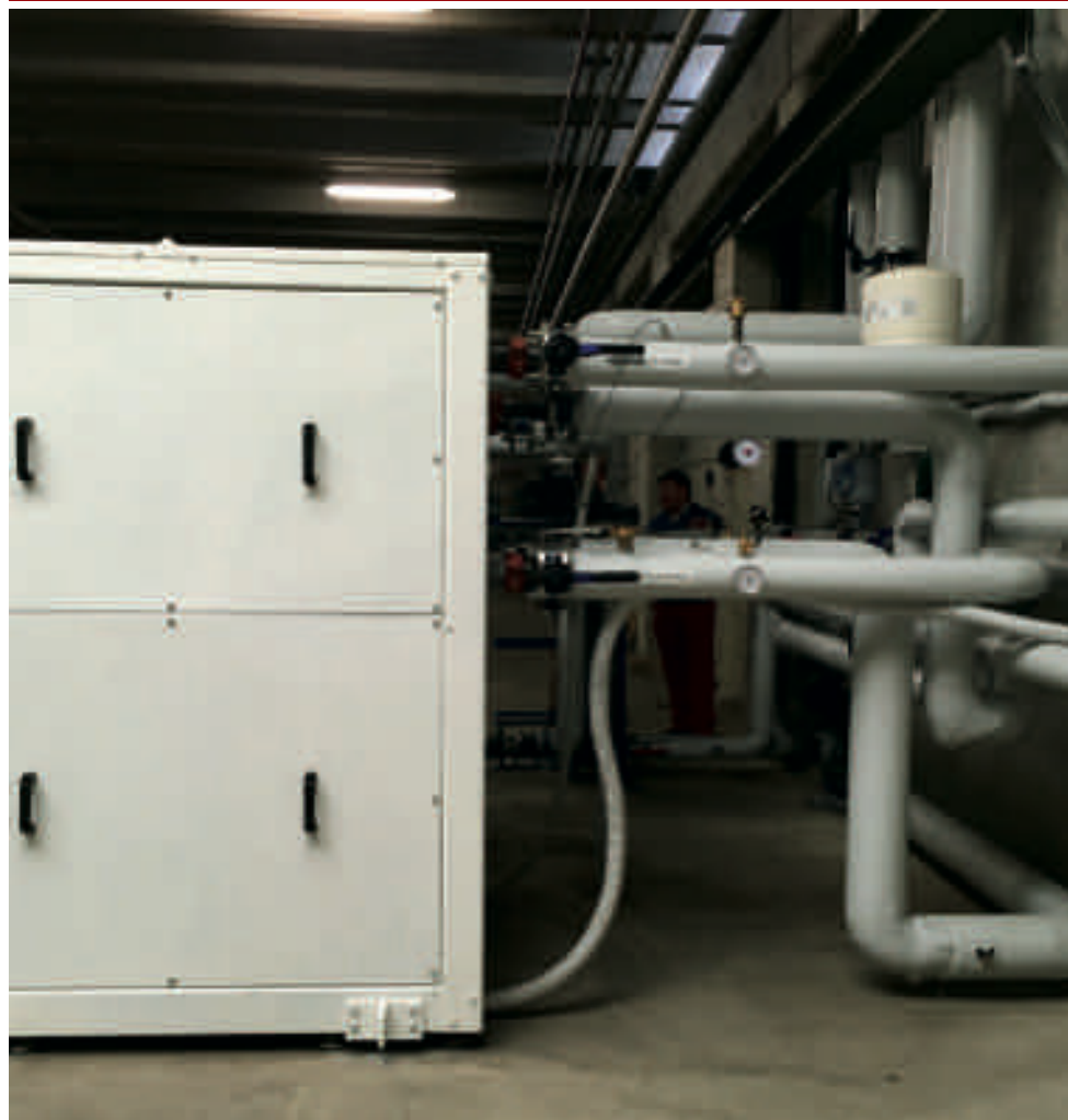
Pompa di calore, Comune di Alpignano (TO)
