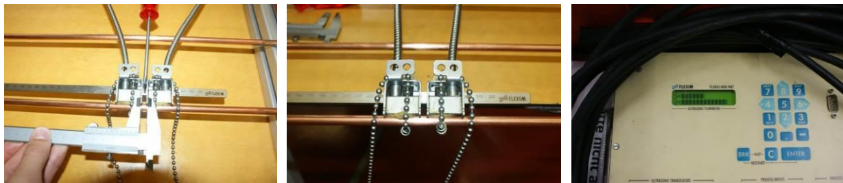
Abbildung 45: Volumenstrommessung in jedem einzelnen Absorberrohr des Rohrregisters. Das Prinzip beruht auf Ultraschalllaufzeitmessung. Links, Mitte: Einstellung des Abstands der Ultraschallsensoren und Fixierung über Federbänder an der Messstelle; Rechts: Signalpegelüberprüfung;
