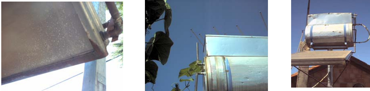
Figura 5.27 Oxidação na estrutura da caixa da placa coletora, falta de limpeza nos vidros da placa e reservatório danificado por pedras.
