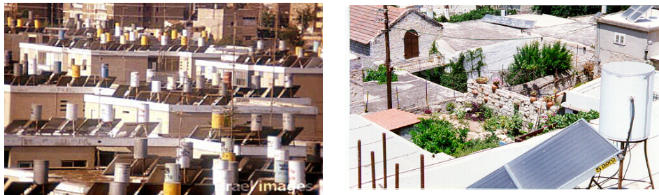
Figura 2.13 Coletores com reservatórios cilíndricos nos telhados de Telaviv 17 , em Israel. Fotos: Israelimages, 2004.
