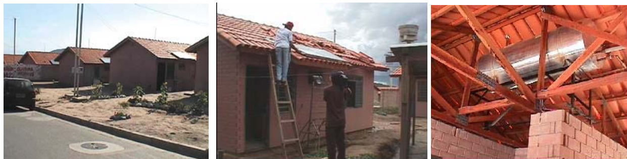
Figura 5.5 O sistema termossolar convencional, com o coletor apoiado no telhado e o reservatório no interior da moradia, em 2000, no Projeto Sapucaias. Fonte: Pereira et al., 2003b.
