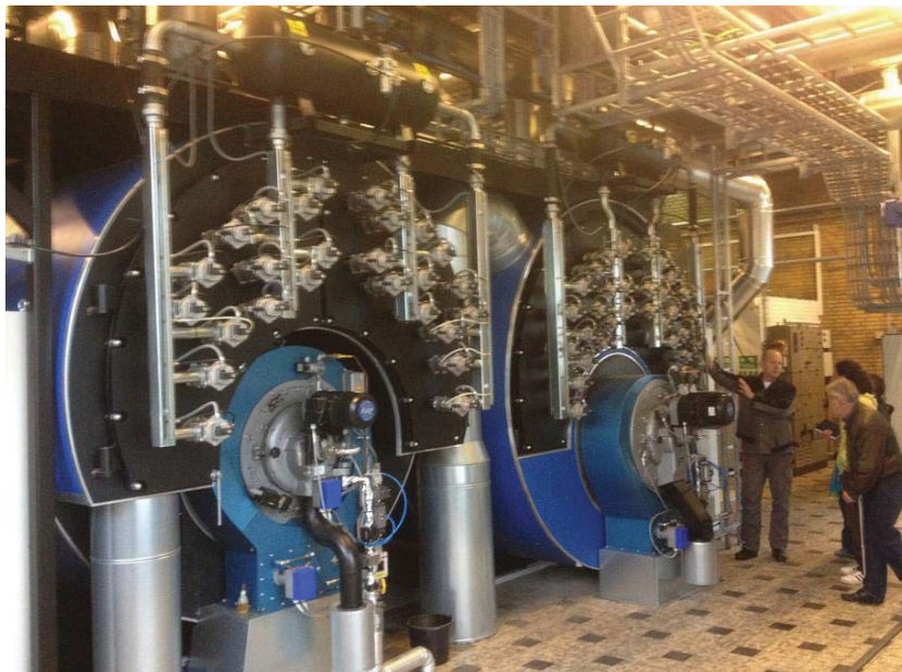
Електрически бойлери, които работят при наличие на евтина вятърна енергия
