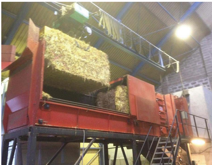
Зареждане на бали слама и автоматично подаване към котела
